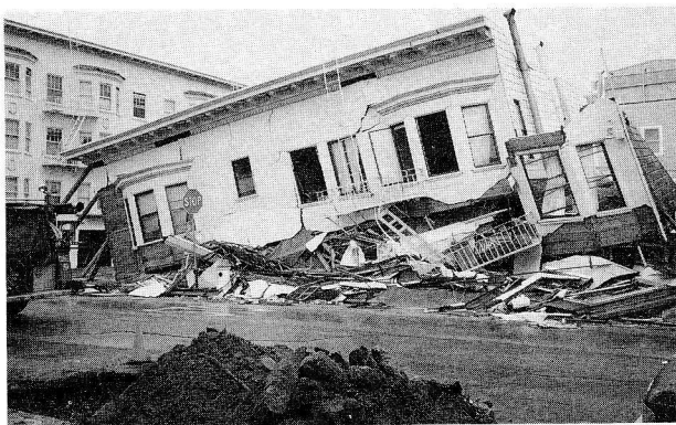
マリナー地区の倒壊した住宅
