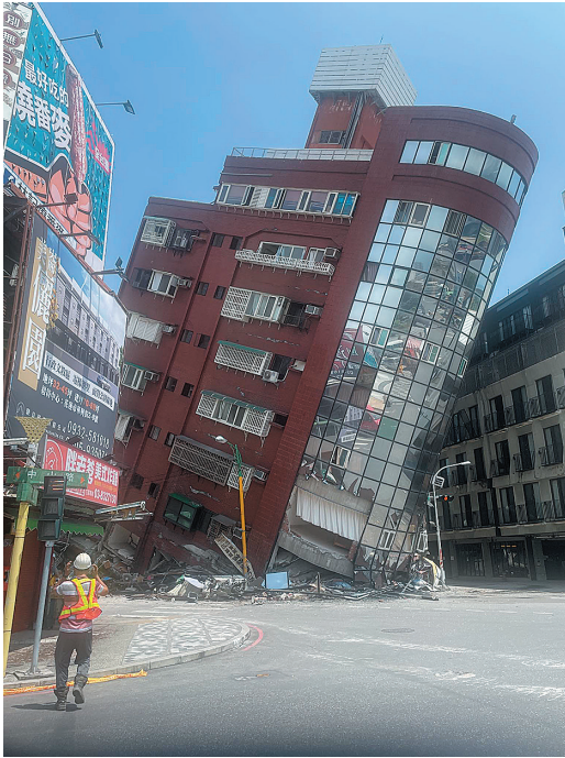
図 1 倒壊した天王星ビル（台湾の公視新聞網から、撮影/陳 添寶）
