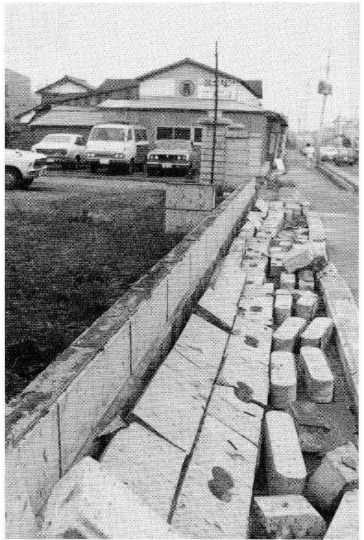
大谷石の塀はもろかった
