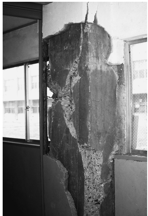
写真 2 八戸工専校舎1階柱のせん断破壊状況（文献3）より引用）
