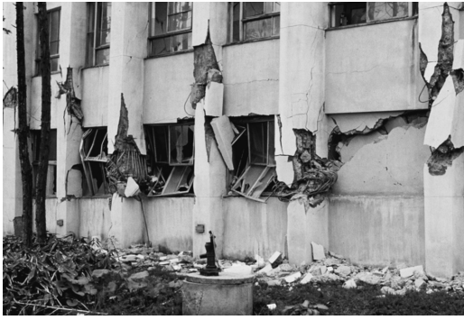
写真 4 函館大学校舎 1 階柱の崩壊状況（文献 3）より引用
