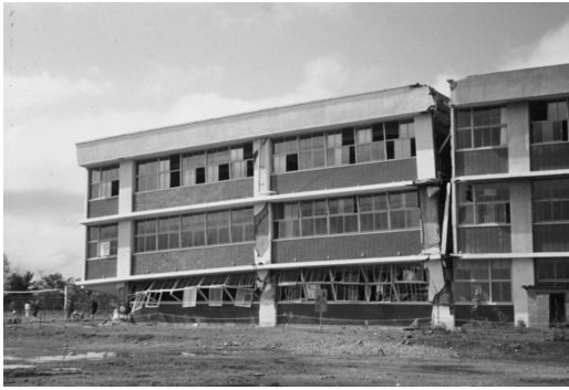
写真3 三沢商高校舎（増築部分）1階での層崩壊状況（文献3）より引用
