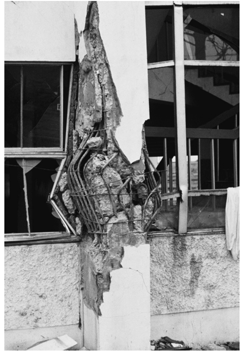
写真 5 函館大学校舎 1 階柱のせん断破壊状況（文献 3）より引用
