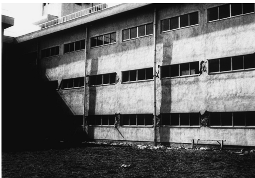
写真 1 八戸工専校舎1階柱のせん断破壊，2階柱のせん断ひび割れ状況（文献3）より引用）
