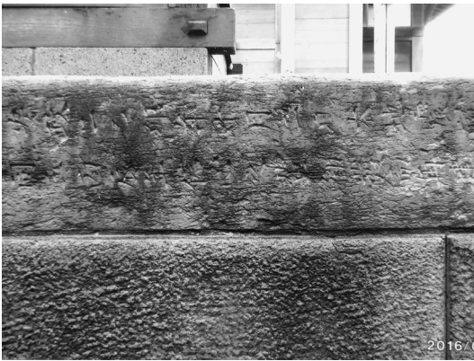
図 5 愛宕神社本殿基壇の切石の1つ 安政江戸地震の被災について刻字されている。
