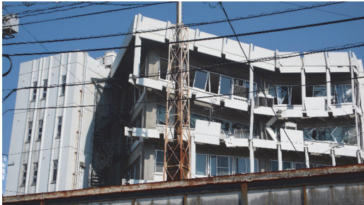
図 4 宇土市役所の被害
