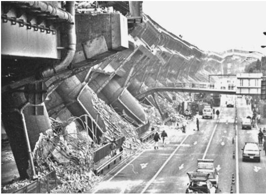
写真 1 兵庫県南部地震によって倒壊した阪神高速道路3号神戸線の“ピルツ橋”
