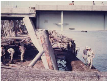
写真 2 八千代橋の被災状況 (渡辺隆博士撮影)
