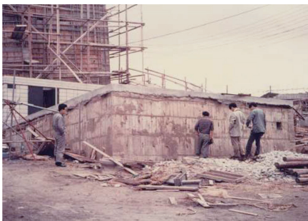
写真7 浮き上がった浄化槽（渡辺隆博士撮影）
