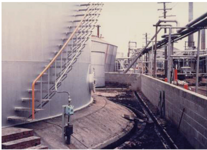
写真 6 沈下・傾斜した石油タンク（渡辺隆博士撮影）
