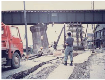
写真 3 越後線信濃川橋梁の被災状況 (渡辺隆博士撮影)
