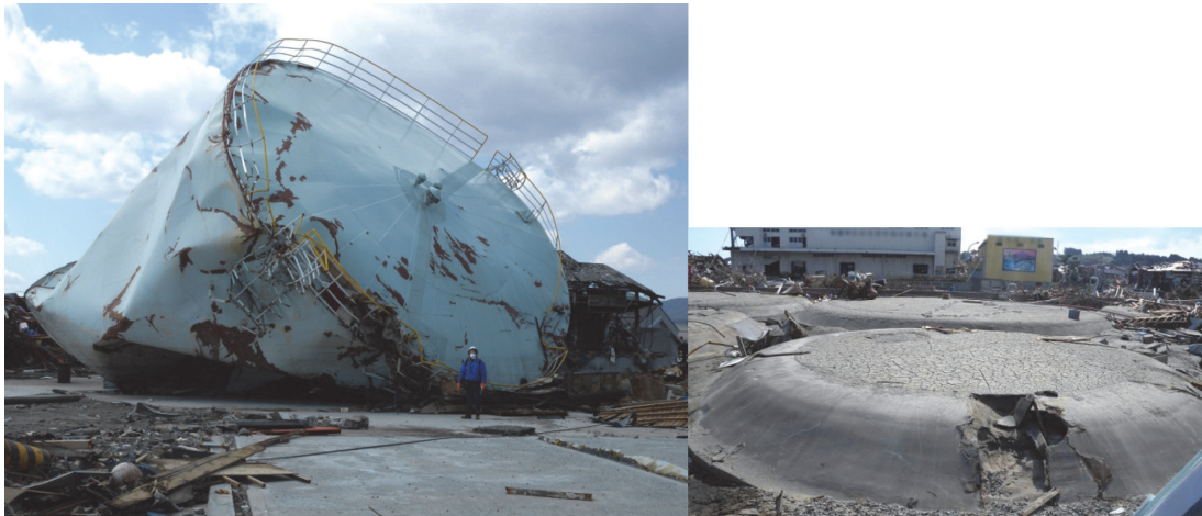
図 4 津波によって浮き上がり移動したタンク（左）とタンクの基礎部分（右）
