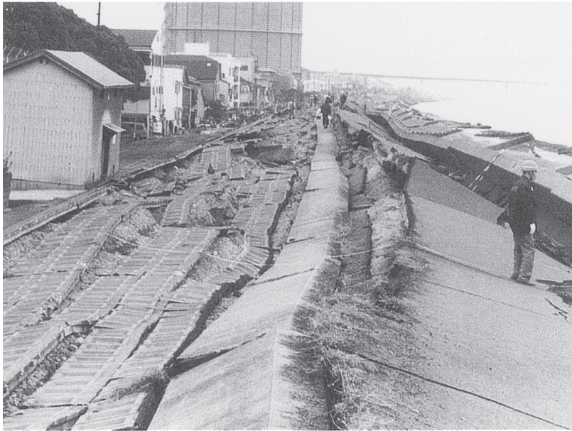
淀川西島地区被災状況（1995年阪神・淡路大震災） （地盤工学会，土木学会，日本機械学会，日本建築学会，日本地震学会の調査報告書より）
