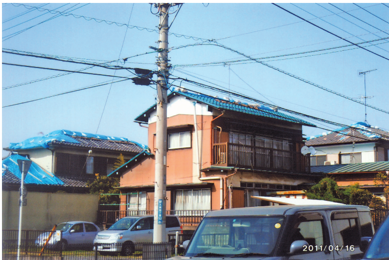
写真 2 鴻巣駅西口住宅地の屋根瓦被害
