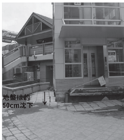
写真 6 地盤の沈下状況（浦安市）
