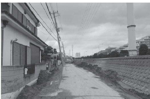
写真 4 旧護岸そばの生活道路で発生した突き上げ現象（浦安市）
