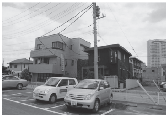
写真 1 沈下・傾斜した家屋（浦安市）
