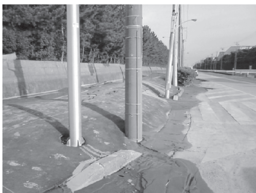
写真 3 幹線道路の歩道で発生した突き上げ現象（浦安市）
