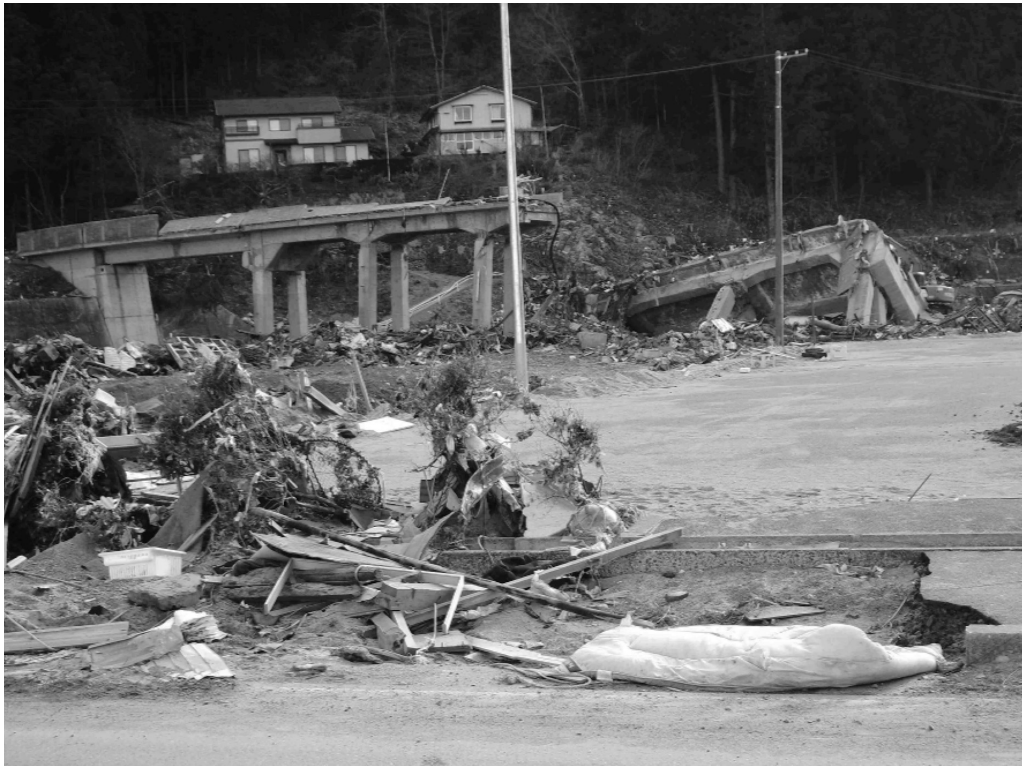
図 10 岩手県田野畑村島ノ越の三陸鉄道高架橋部分の津波による倒壊。向こう側に高所に残った2軒の家が見える。
