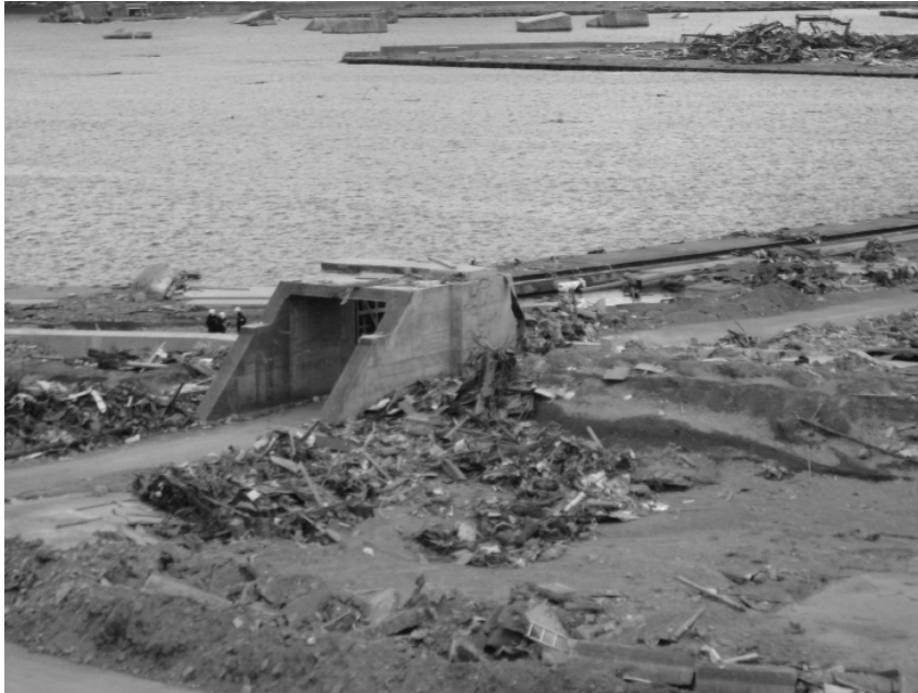
図 9 完全崩壊した田老町の新防潮堤（道路ゲート部分）
