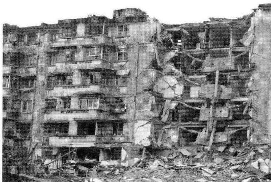
図 10 接合部破壊による建物の破壊 (綿竹市漢旺)
