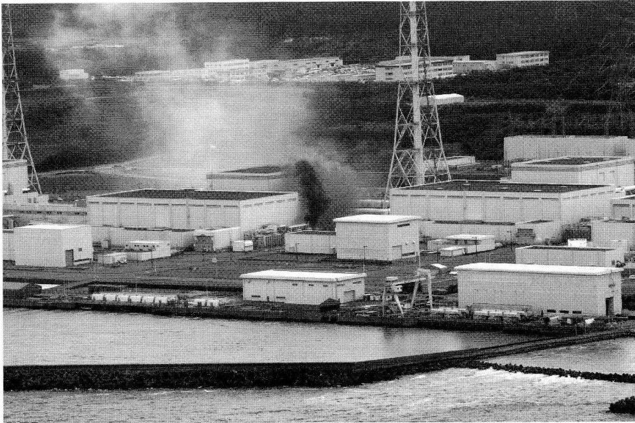
写真1 東京電力、柏崎・刈羽原子力発電所の変圧器火災（第9管区海上保安本部提供）
