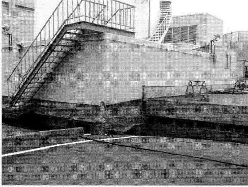
写真2 構造物周辺の地盤沈下 (東京電力提供)
