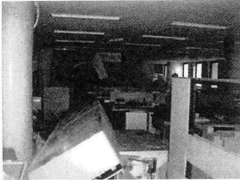
写真5 一般建屋（事務棟，Cクラス）内部では、天井落下，事務機の散乱などが起こった。（東京電力提供）
