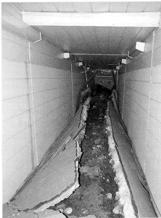
写真 7 地震土圧で壊れた川口駅地下道
