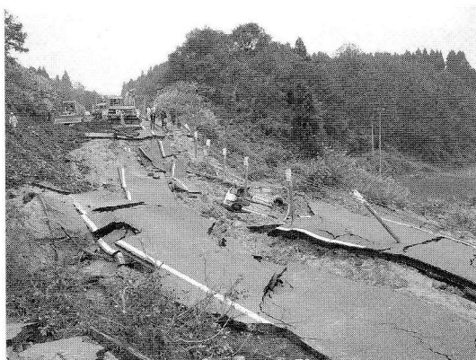
写真 6 道路盛り土の破壊と復旧
