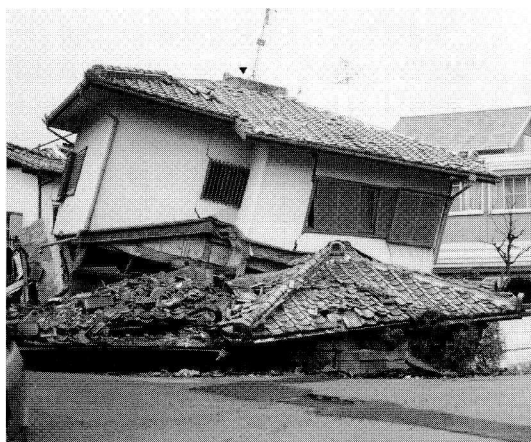
写真1 1階が層破壊した家屋
