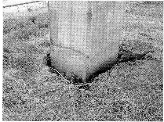
写真 8 新幹線橋脚大揺れのため、地盤と隙間
