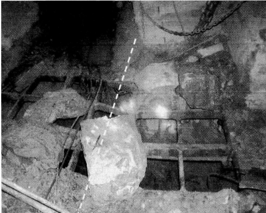
写真 1 図 6 の矢印の地点で見られた水平右横ずれ。中央手前の岩の上のボールペンがスケール。断層が画面のほぼ中央を、上下に走る断層 (点線) が右横ずれを起こしたために、右から 3 番目の鉄格子が平行四辺形に変形した。壁面には新鮮な亀裂も確認できた (写真省略)。
