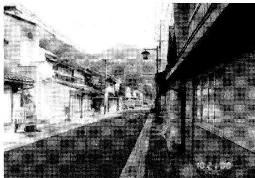
全壊家屋は多いが倒壊家屋は見えない街並み、日野町、2000年鳥取県西部地震
