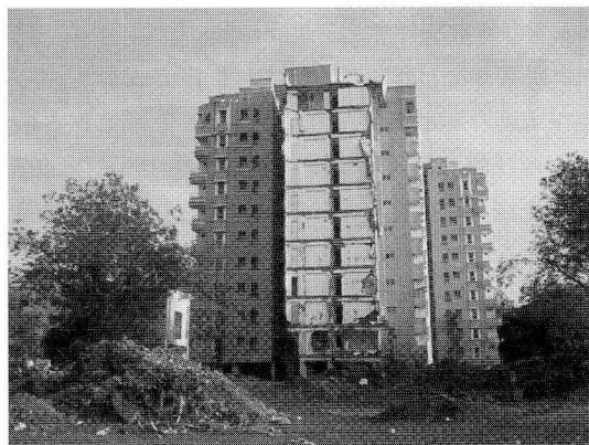
写真 4 アーメダバード市、高層アパートの手前側ブロックが倒壊
