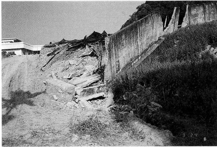
写真 5 大甲溪南部の地震断層で生じた崖。上盤側での家屋の破壊がみられるが、耐震設計がされた白い家は無事であった（地点4）。
