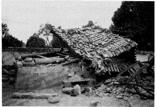
写真4 倒壊した中勝寺の鐘楼
