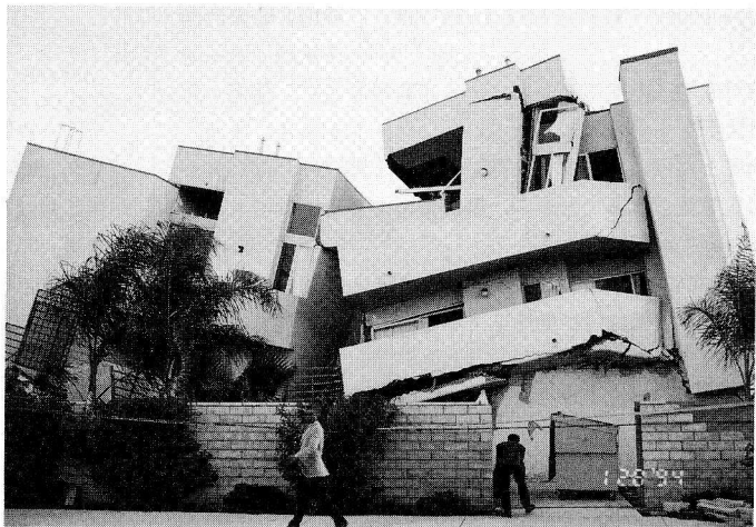
木造3階建の倒壊 [グレンデール地区]
