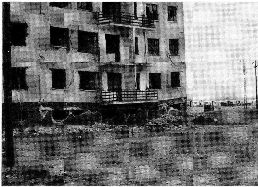
写真2 4階建の鉄筋コンクリート・ビルの被害 基礎の柱と梁の結合部が破壊されている。
