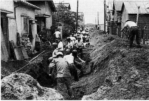
図3 液状化で被害を受けたガス管の復旧（新潟地震）一折れたガス管のなかに砂が流れ込んでしまったため、掘上げて洗浄し埋め直すという手間のかかる工事となった。
