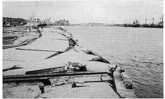
写真3 日本海中部地震による護岸の被害
