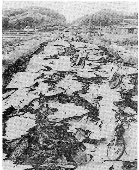
写真4 日本海中部地震による盛土の被害
