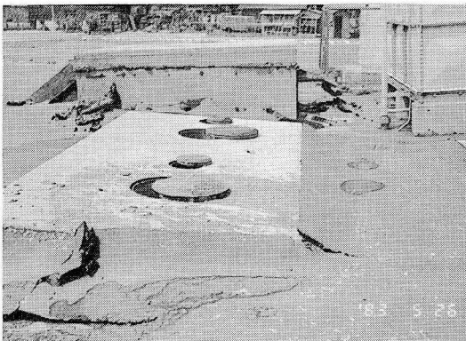
写真2 日本海中部地震による浄化槽の浮上
