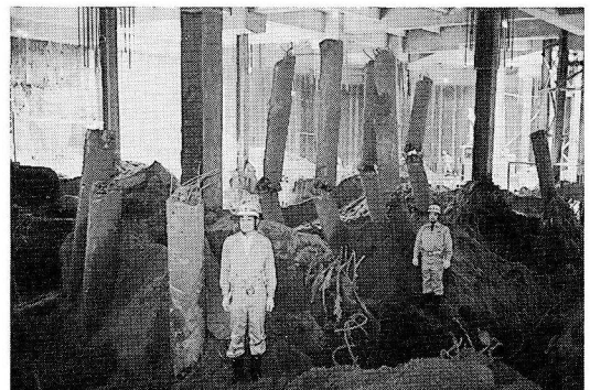
写真7 Nビルの基礎杭の被害（河村 33）による）
