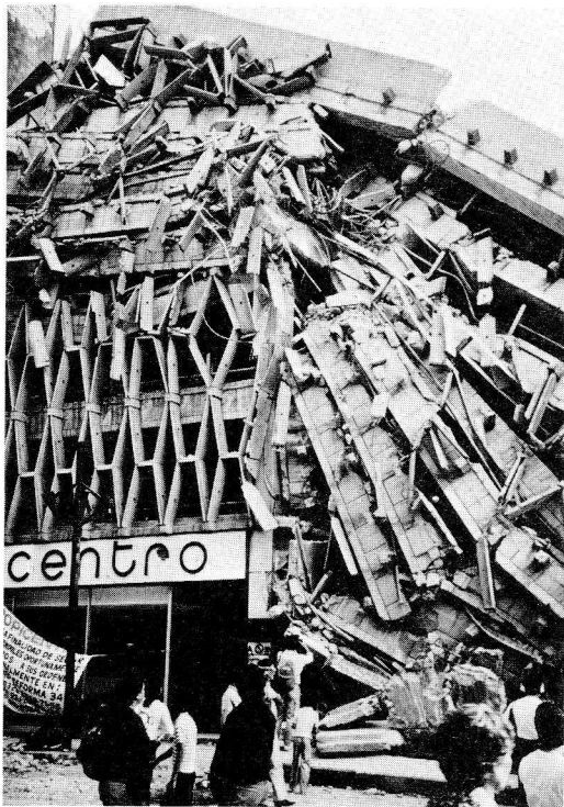
写真2 駐車場の崩壊 床の枚数から何階建であったかわかる。
