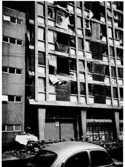
写真5 レンガ壁はメキシコ市に多く見られるが、耐震性が弱い。一部の窓ガラスは壊れていない。
