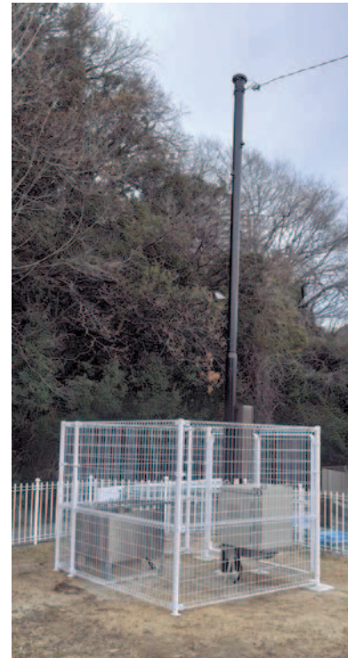
図4: 小型 BSM 観測施設全体写真. フェンス内左側が井戸, 右側の白い筐体内に地上装置が納められている.
