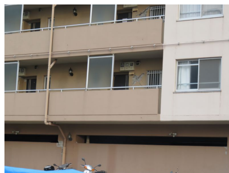
写真36 S.A. マンションの玄関横の外壁にキレット
