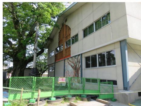
写真32 詫麻西小学校体育館の外壁被害
