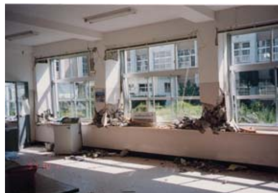
図 5 宮之城高校の校舎被害 (解説・学校建築の被害は昭和 43 年の十勝沖地震の再来を想起させた。耐震補強を実施しておれば防げた被害であった。)
